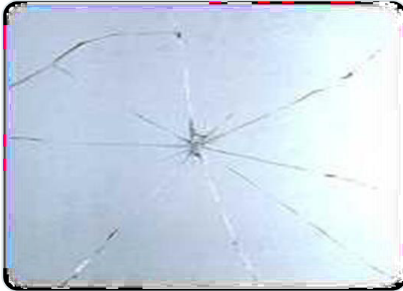
Imagen del informe original: rotura por acción puntual/impacto en vidrio no templado, con origen visible y propagación radial.
